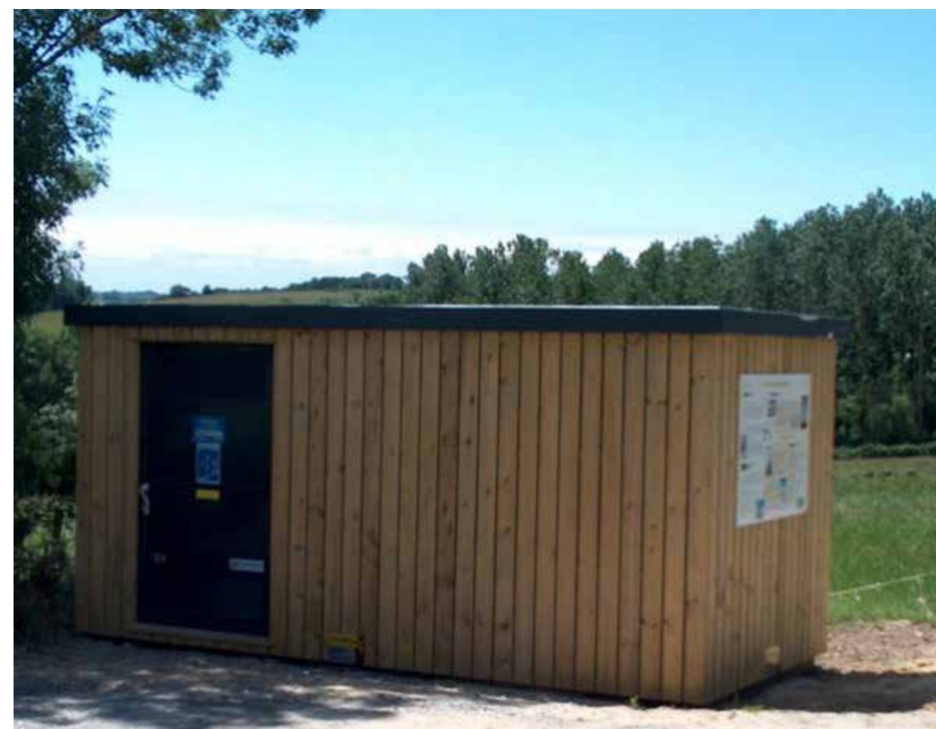
Fig. 132 : Poste de livraison , bardage bois, SEL Enerbéton
